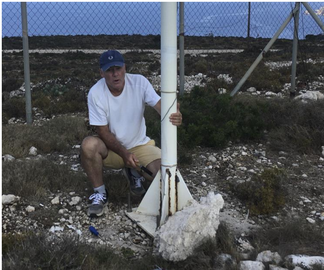
Εικόνα 1.2-5: Απο τις τεχνικές εργασίες στον σταθμό ΚΕΦ-2 στις 26/8/2022. Αφαίρεση οξείδωσης απο το πέλμα στήριξης του ιστού.
