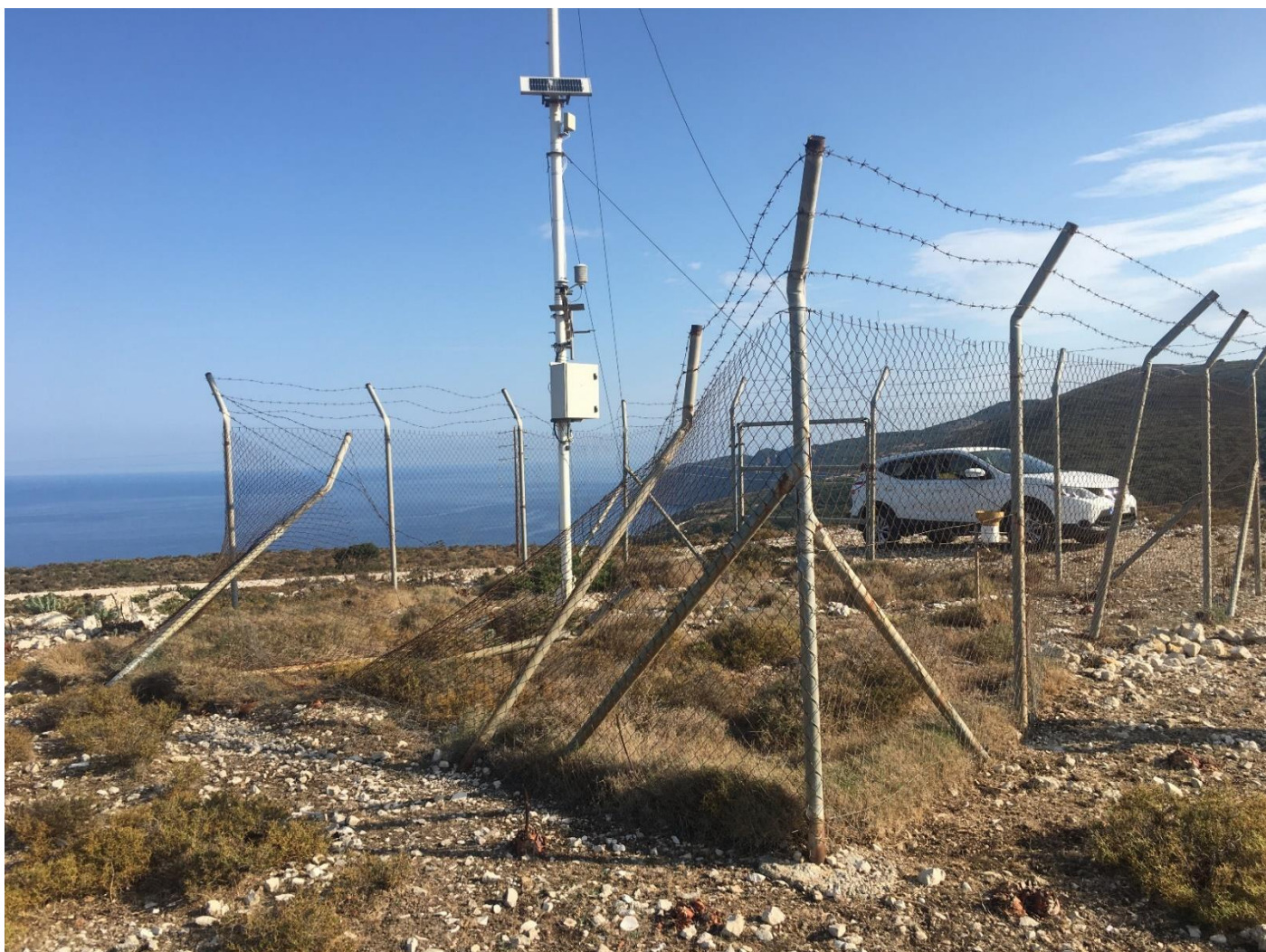
Εικόνα 1.2-2: Τμήμα της κατεστραμμένης περιφράξης του σταθμού ΚΕΦ-2 (26/8/2022).
